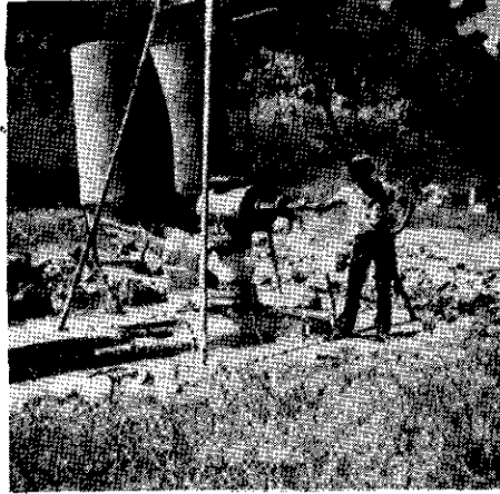
Pozo geotérmico "El Tronador", en Berlín, Departamento de Usulután
